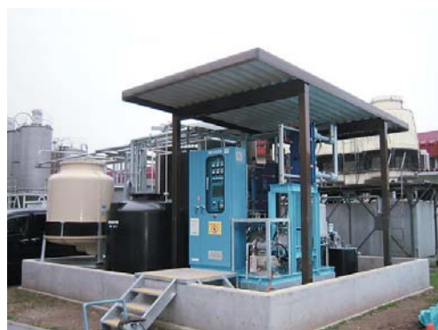
伸線液廃液の濃縮装置
