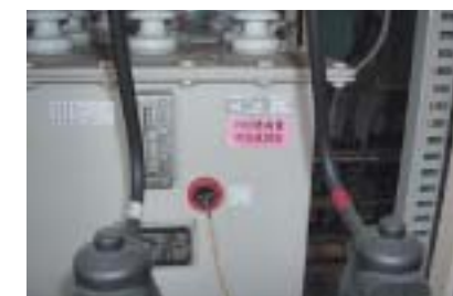
PCB含有未確認の機器
