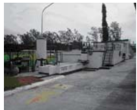
廃水処理施設(処理能力220t/日)
