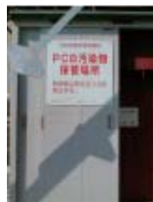
PCB保管場所
