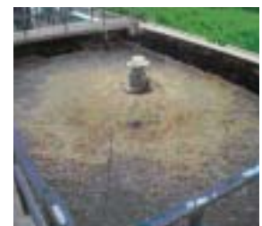
排水処理エアレーションタンク
