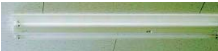
人感知センサーを取付けて点灯、消灯を自動化
